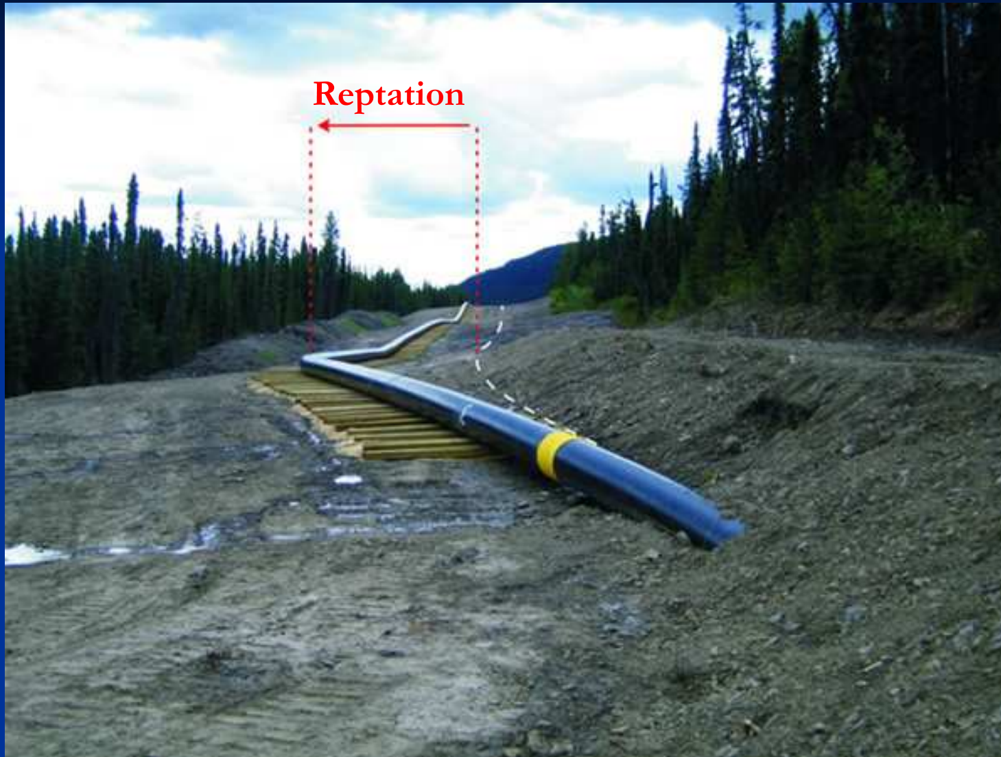
Fig.3 Le mouvement des débris d'érosion a déplacé un gazoduc. Sa position initiale est indiquée par une ligne blanche tiretée.
