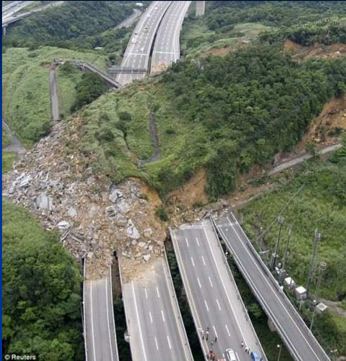
Fig.5 Glissement de terrain
